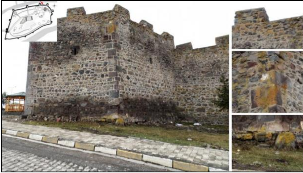
Şekil 10. Kuzey Duvarlarında Biyolojik Oluşumlar
