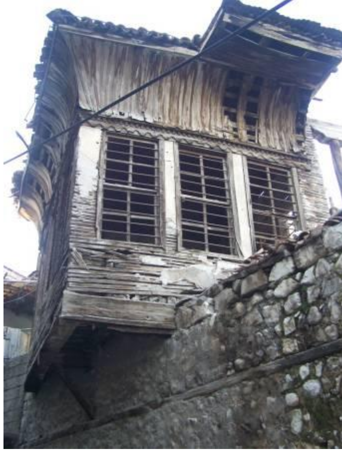
Şekil 13. Ahşap kaplama saçak çıkması (Envanter no:143)
