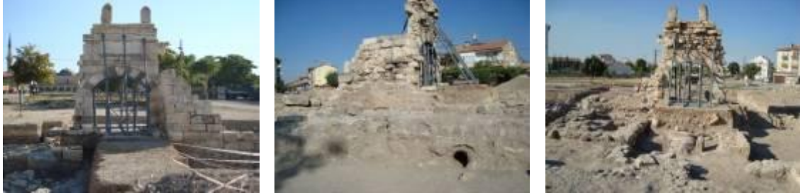
Şekil 7. Onarımı yapılmamış, yıkılmaya terk edilmiş kale kapısı
