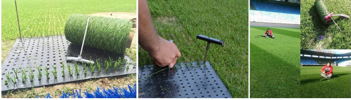
Şekil 6. Çaykur Rize Didi Stadı hibrit uygulama sonrası deforme olan alanlarda elle hibrit uygulaması
