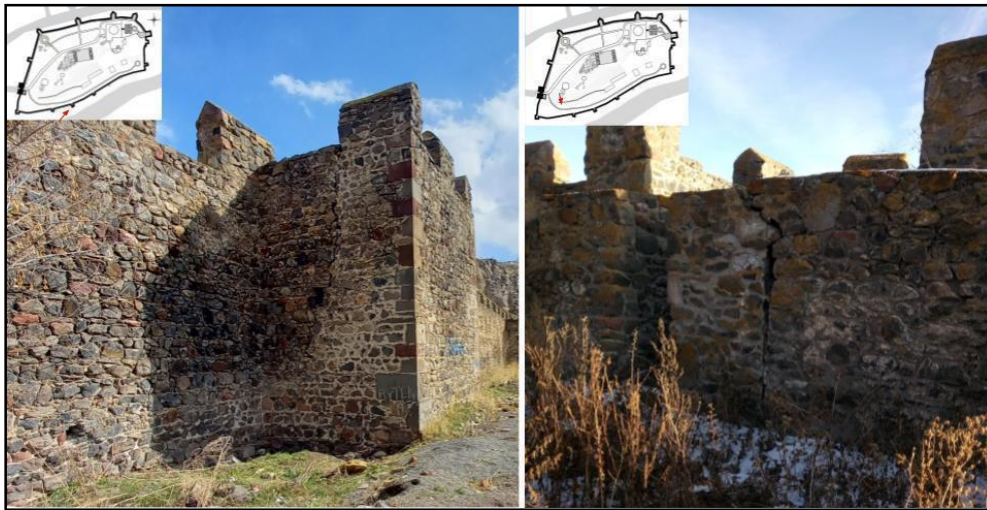
Şekil 8. Ardahan Kalesi Güney Surlarında Çatlaklar
