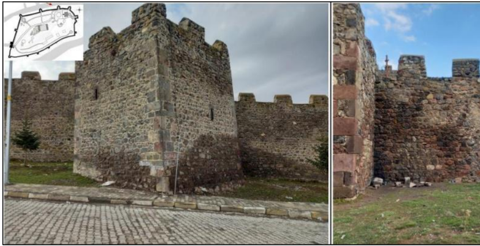
Şekil 9. Kuzey Duvarlarında Yerden Yükselen Nem Problemi
